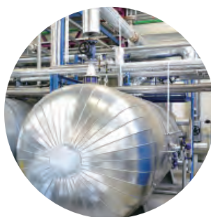
發電廠冷卻用水 / 鍋爐給水
