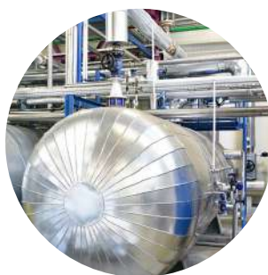
發電廠冷卻用水 / 鍋爐給水
